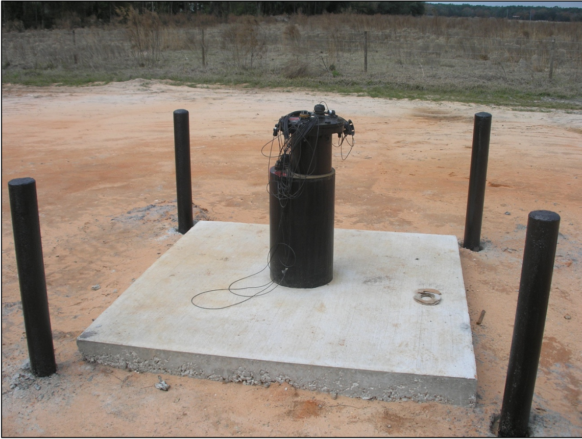
SE DZMW-1 WELLHEAD
