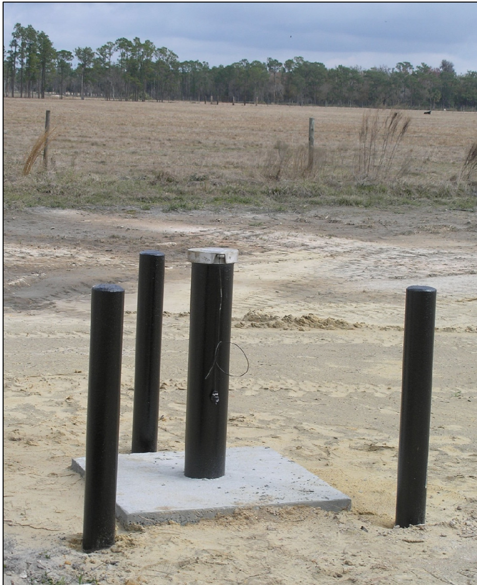
SE SAMW-1 WELLHEAD
